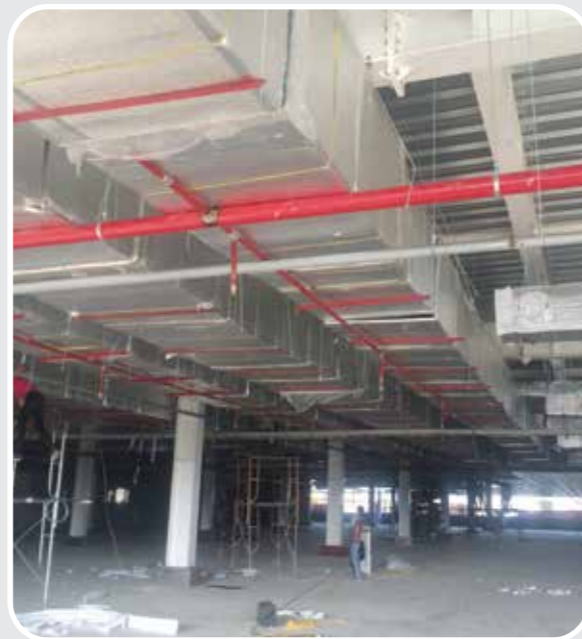
Hệ thống ống gió điều hòa cho công ty DEYANG-HÀN QUỐC (Bắc Giang)
