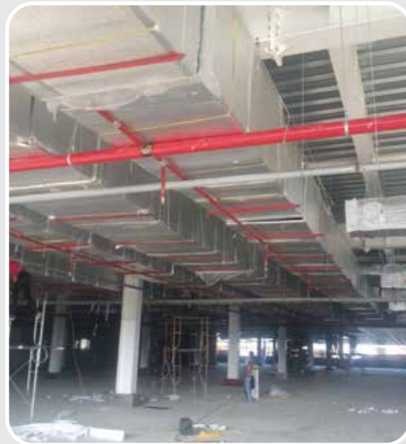
Hệ thống ống gió điều hòa cho công ty DEYANG-HÀN QUỐC (Bắc Giang)
