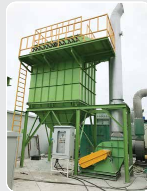
Hệ thống hút lọc bụi dây chuyền đánh bóng kim loại- Công ty SEOJIN-HÀN QUỐC (KCN Tiên Sơn-Bắc Ninh)
