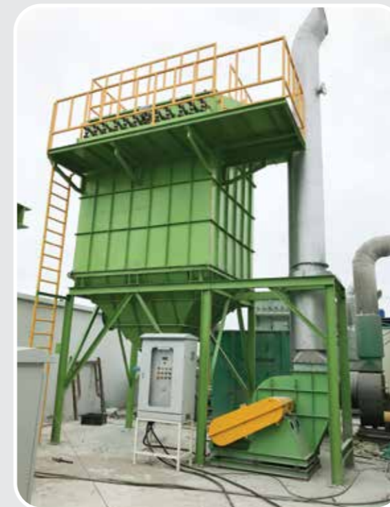
Hệ thống hút lọc bụi dây chuyền đánh bóng kim loại- Công ty SEOJIN-HÀN QUỐC (KCN Tiên Sơn-Bắc Ninh)
