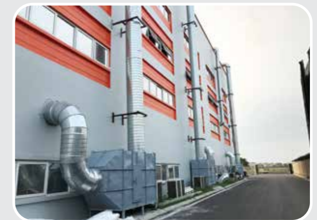
Hệ thống hút và khử mùi dây chuyền mạ cho nhà máy TEXON-HÀN QUỐC (KCN Tiên Sơn-Bắc ninh)
