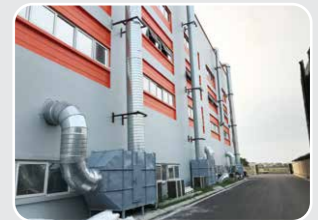
Hệ thống hút và khử mùi dây chuyền mạ cho nhà máy TEXON-HÀN QUỐC (KCN Tiên Sơn-Bắc ninh)
