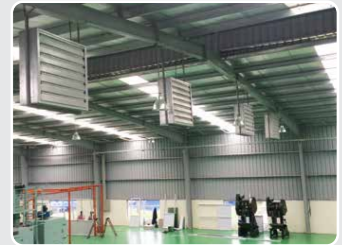
Hệ thống thông gió nhà xưởng công ty CP Quốc tế Sơn Hà Thị trấn Phùng - Hà Nội
