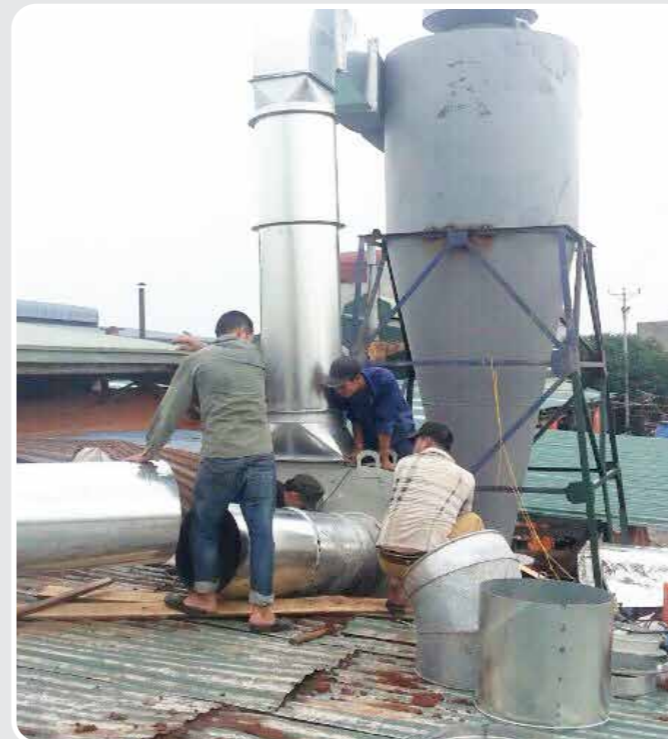
Hệ thống hút lọc bụi gỗ - Công ty Gỗ Sơn Lâm Thị Trấn Thường Tín - Hà Nội
