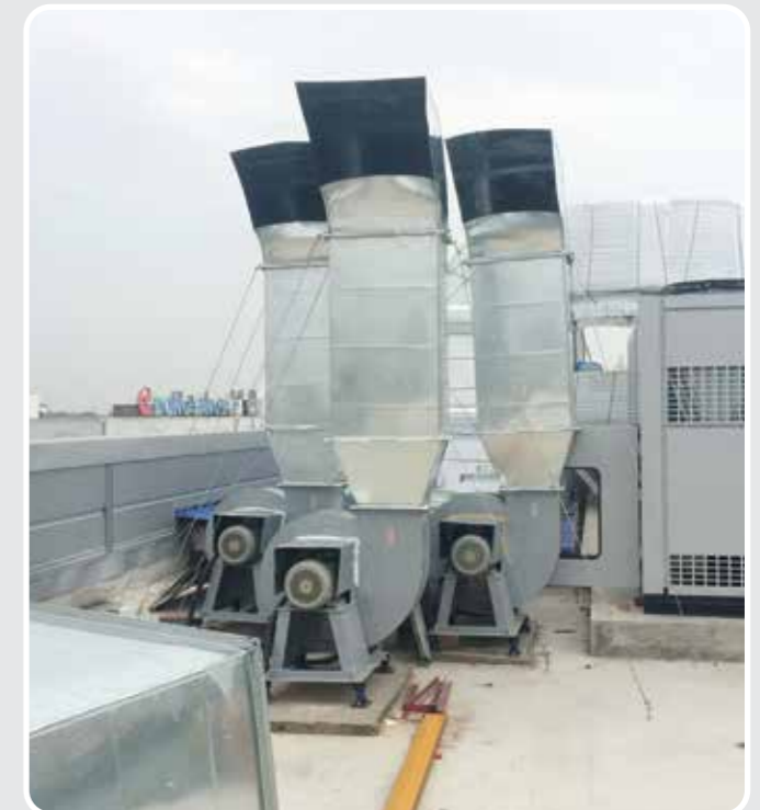
Hệ thống hút mùi công ty Dongyang E&P Nhân Hòa, MỹHào, HưngYên
