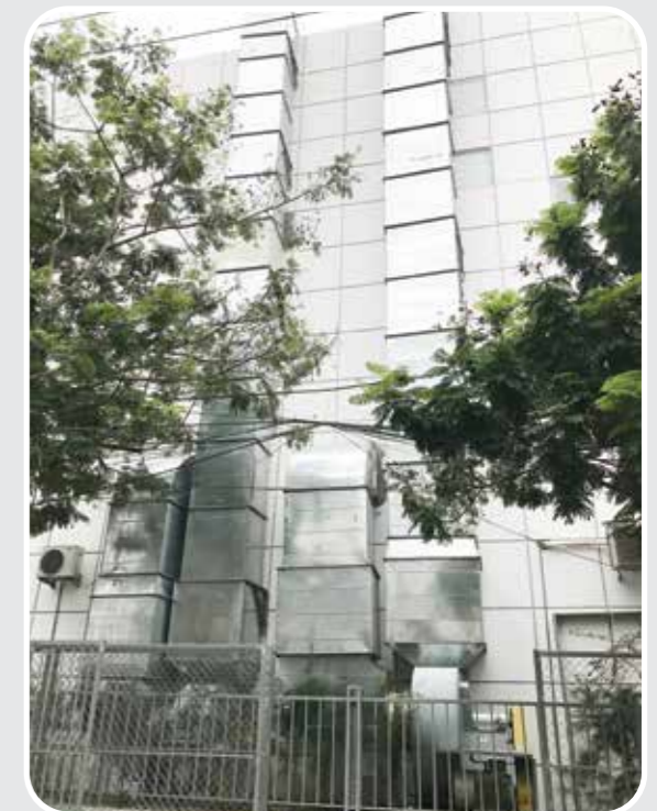
Hệ thống hút và khử mùi bếp công nghiệp cho Khách sạn Royal Lotus (TP Đà Nẵng)
